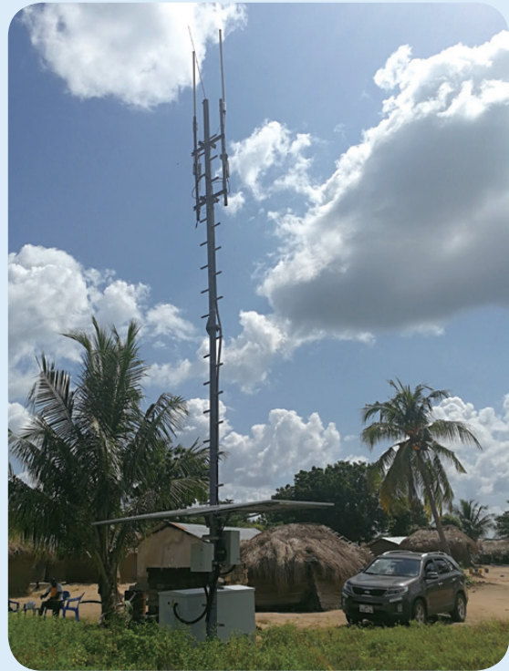
使用太阳能供电的加纳农网
